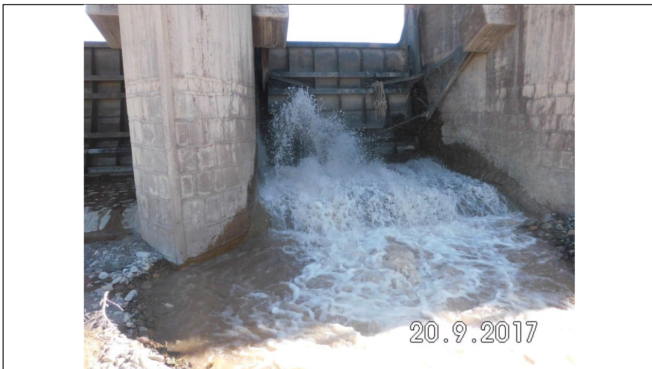
Pérdidas en la compuerta N° 2 de gran magnitud. Se observan daños en el umbral y en pistas de sellos circulares laterales.
