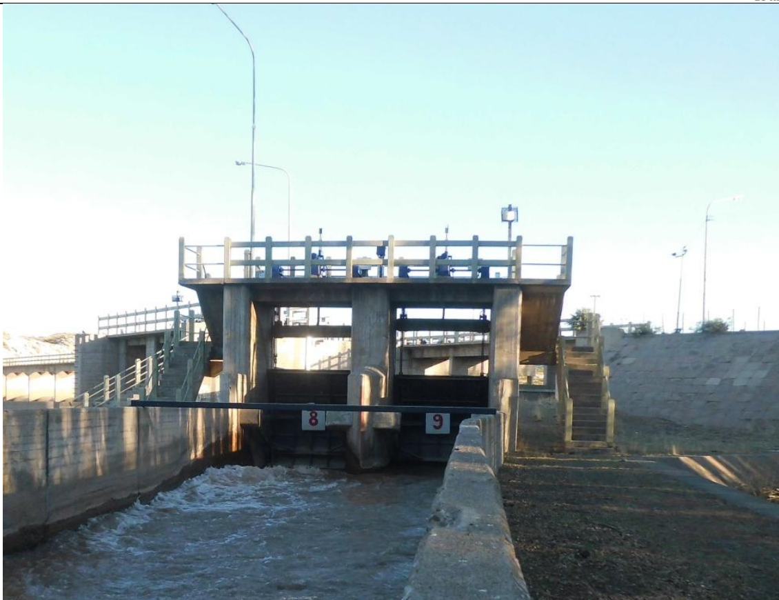
Vista de las compuertas de alimentación al Canal Matriz
