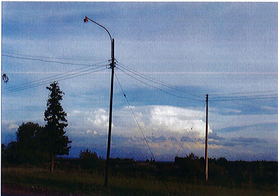
Figura 86. Instalación red de alumbrado público
