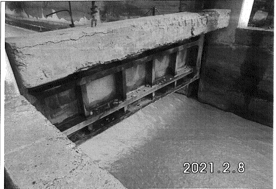
Parte posterior de compuerta central de ataje, contrapeso, cables y elementos de sujeción con evidentes signos de corrosión
