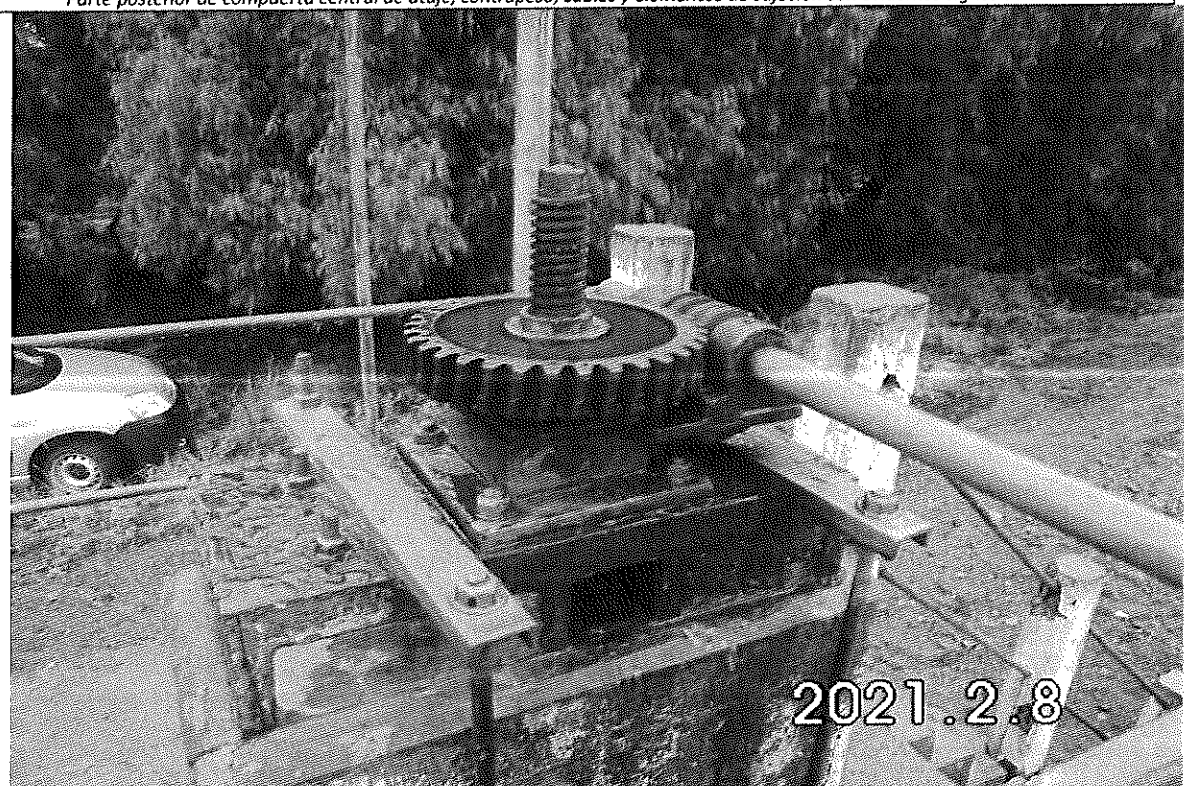
Reductor derecho con problemas de funcionamiento, por tal motivo se debera cambiar la tuerca de bronce por el deteriro de su rosca cuadrada de paso 10 mm.
