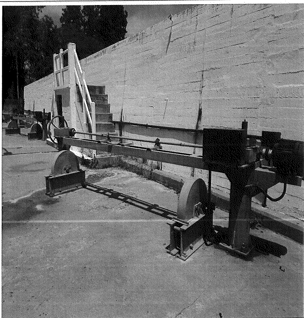
Cuadro de Maniobras de la Cámara desarenadora del Dique Cipolletti en regular estado. Por tales circunstancias, serán reparados en su totalidad.
