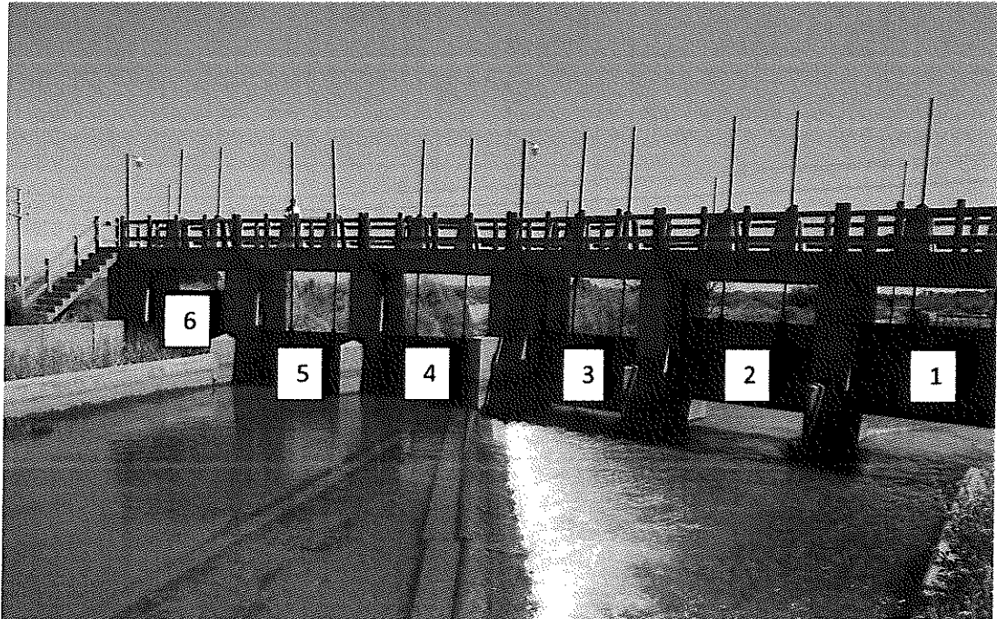
Figura 2 : Vista posterior (aguas arriba) del Dique Galigniana. Se deberá reponer motor en compuertas 1, 2, 3 y 5.
