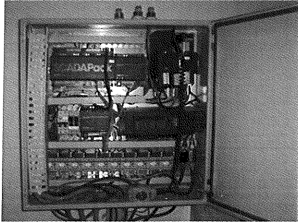
Foto Nº 1 Estación en Dique Cipolletti
