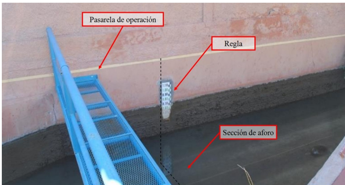
Figura 9 Canal Rama Chimba. Aforador Hidalgo.
