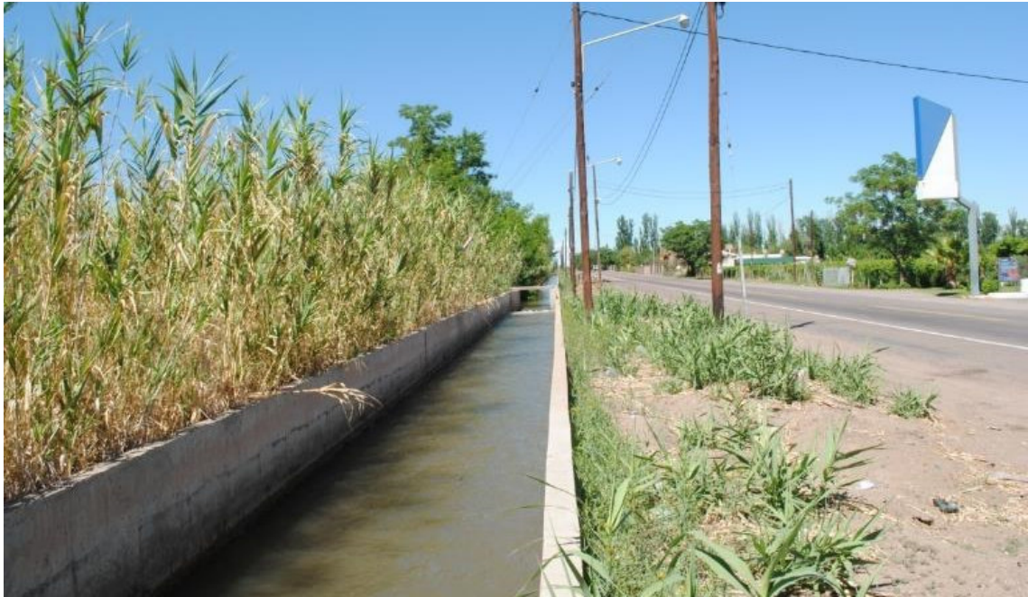
Figura 8 Canal Rama Chimba. Sección revestida existente.
