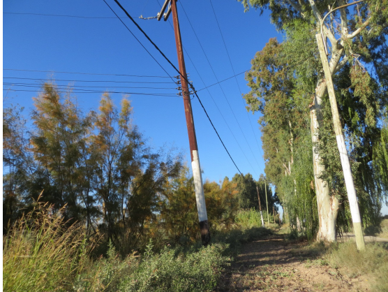
Foto 4: Línea eléctrica próxima al canal (Toma Menéndez)
