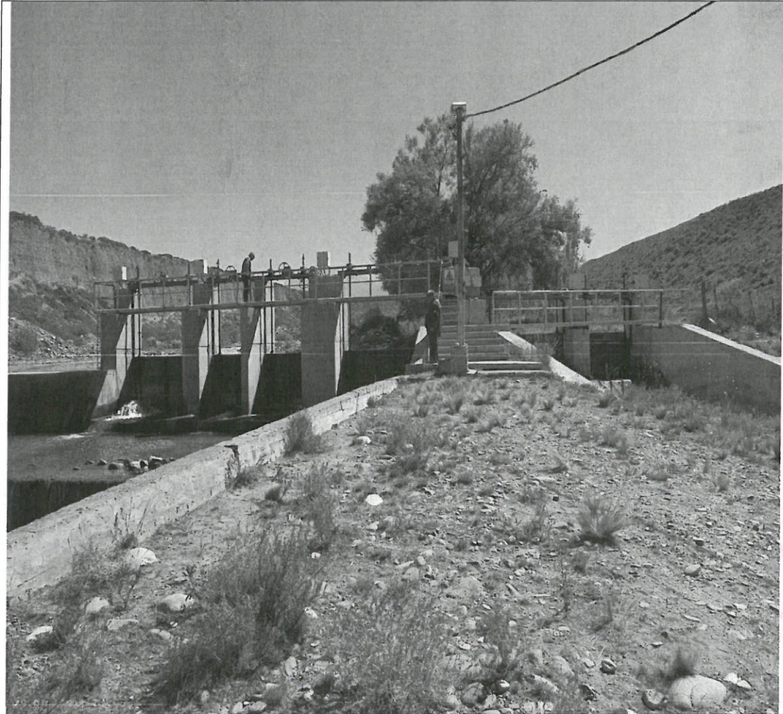
Dique las Tunas: En los cuadros de maniobras de las compuertas de ataje al Rio las Tunas y en el Canal Matriz se colocaran Techós Cobertores, y minimizaran las perdidas en compuertas.
