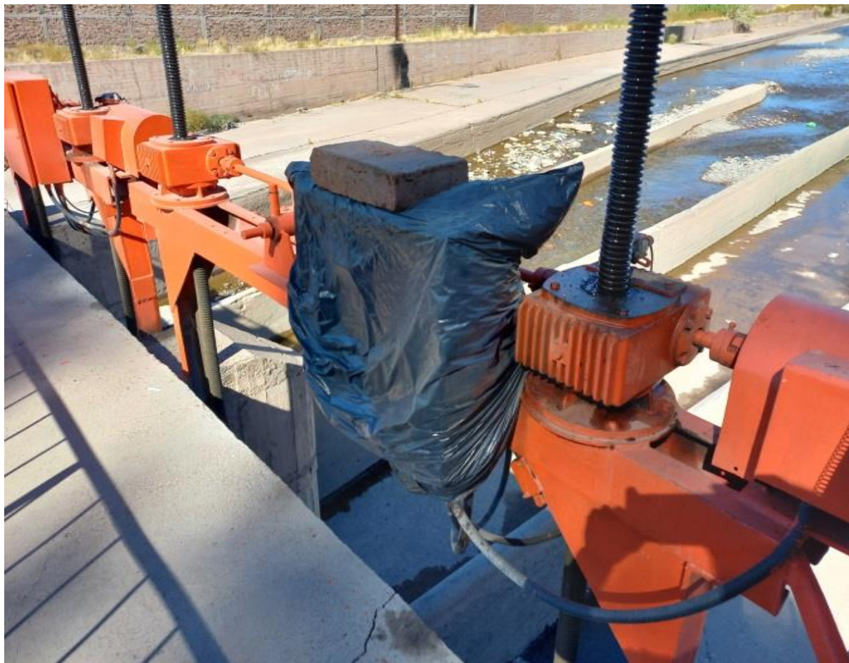
Figura 3: Cuadro de maniobras del Dique el Algarrobal, sus electromecanismos se encuentran en regular estado.
