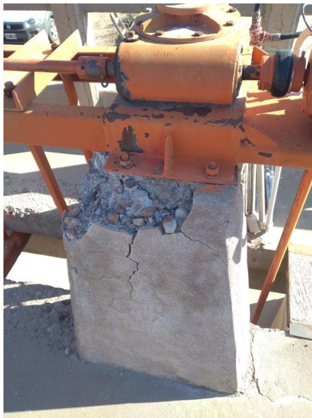
Figura 8: Como consecuencia de fallos en los finales de carrera, las compuertas presentan rotura de pilas y bastidor fuera de posición Se debe reparar su cadena cinemática y dejar en perfectas condiciones de funcionamiento.
