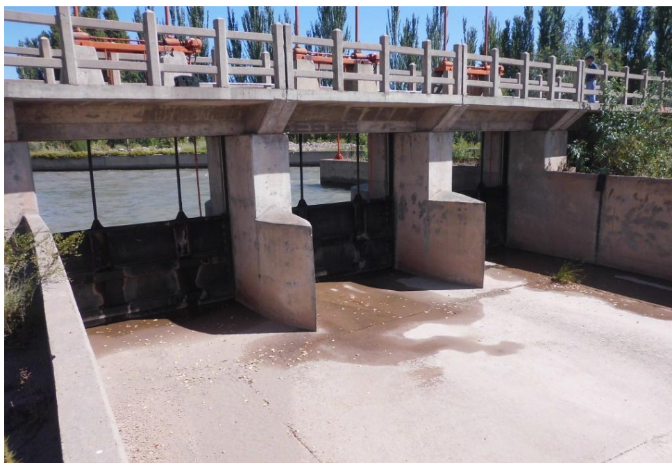
Figura 5: Como consecuencia de fallos en los finales de carrera, las compuertas presentan rotura de pilas y bastidor
