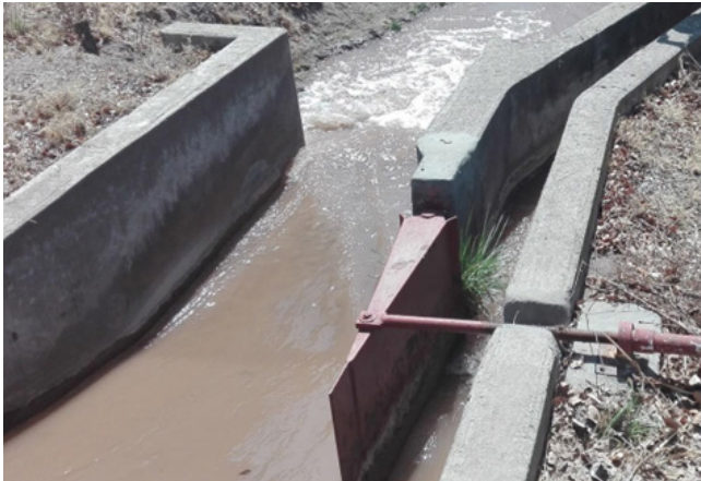
Figura 19: Partidor vista hacia aguas abajo, resalto
