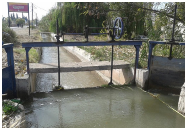
Figura 22: Compuerta baja altura Rama Chimba
