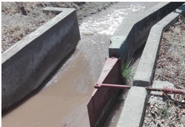
Figura 19: Partidor vista hacia aguas abajo, resalto
