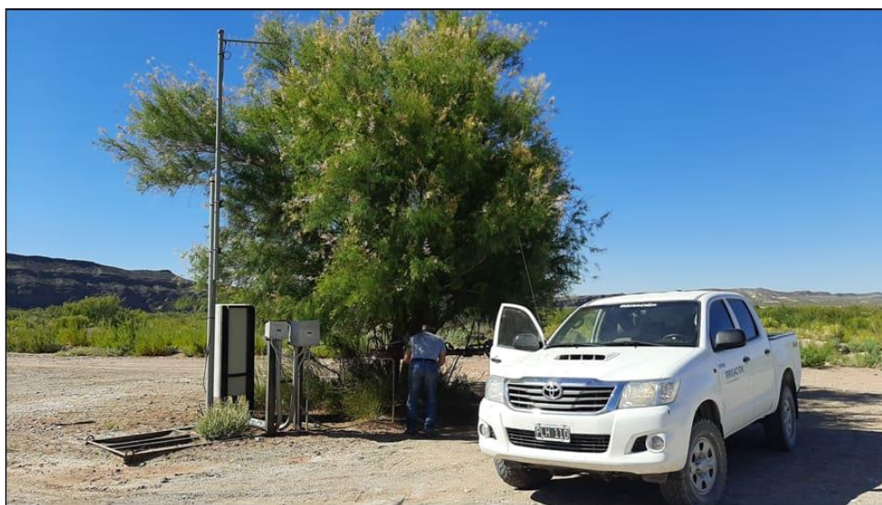
Ilustración 223. Pozo Mendoza I. Yacimiento El Portón (YPF). Captación del Subálveo, con bomba sumergible y sistema de medición por telemetría
